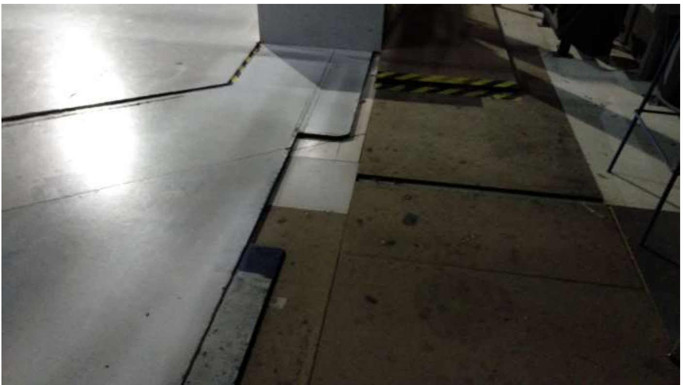
Detalle del suelo que hay que sustituir
